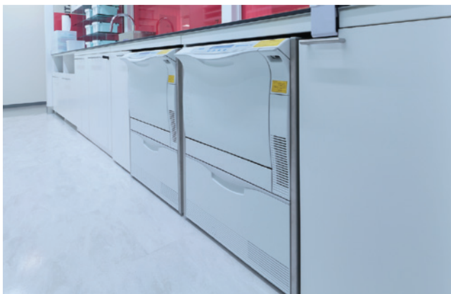
図10 セミクリティカルAとBにリスク分析されたインスルメントは、2台のウォッシャー・ディスインフェクター（WD）にて対応している。
